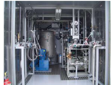
バイオガス精製装置
