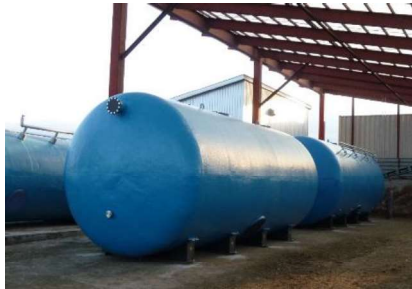
乾式メタン発酵槽
