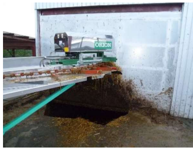
原料自動投入装置・前処理設備
